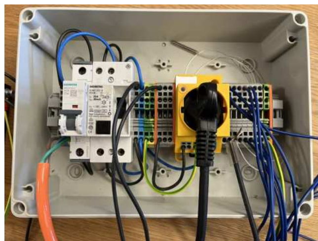
ABBILDUNG 5.11: Verteilerdose des Systems
